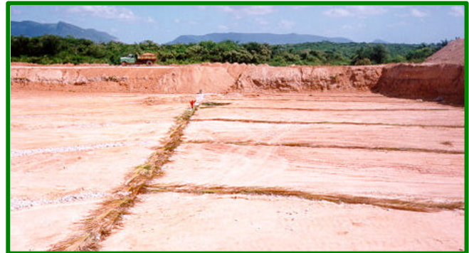
Figura 4 – Vista do sistema de drenagem em um aterro sanitário
